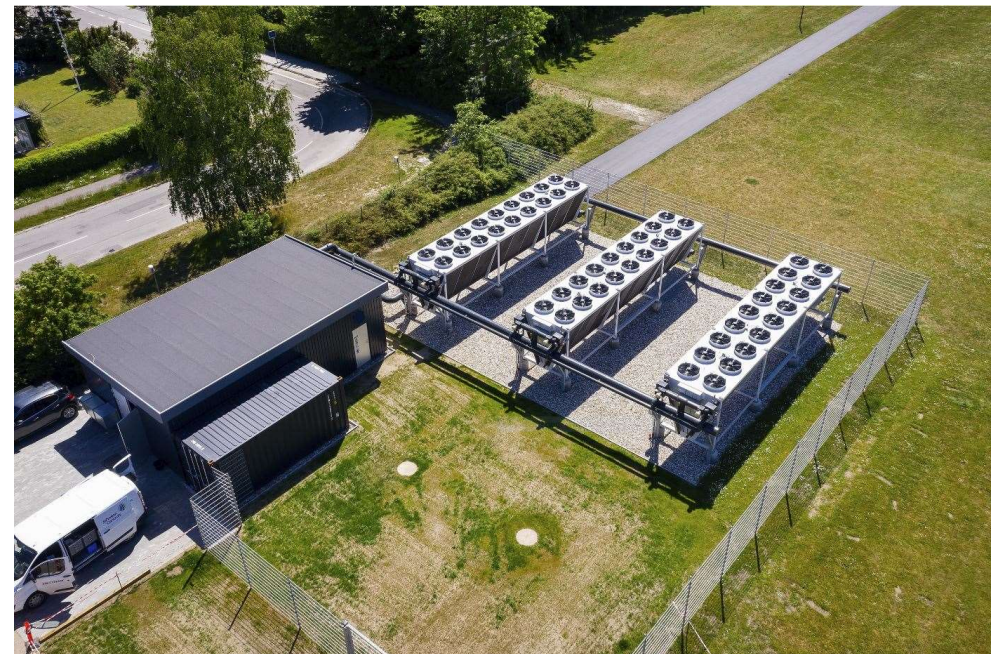
Quelle: PlanEnergi, 1 MW Luft-Wärmepumpe in Dänemark
